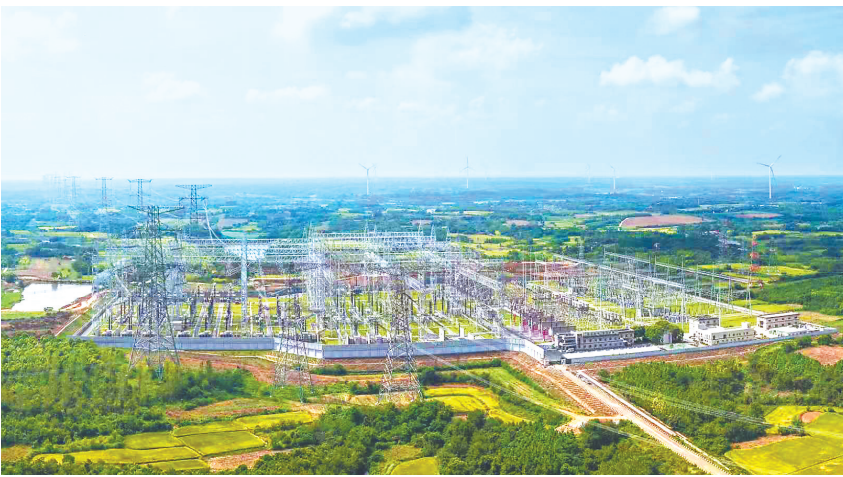
1000千伏荆门特高压变电站矗立在乡野之间。(湖北日报通讯员 陈军 摄)
