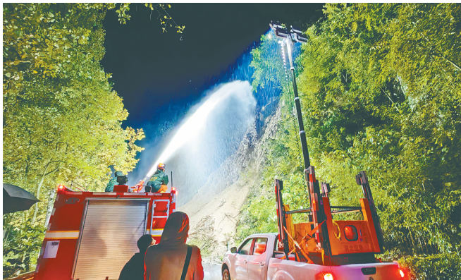
保康县应急抢险人员用高压水枪冲刷垮方山体碎石。
