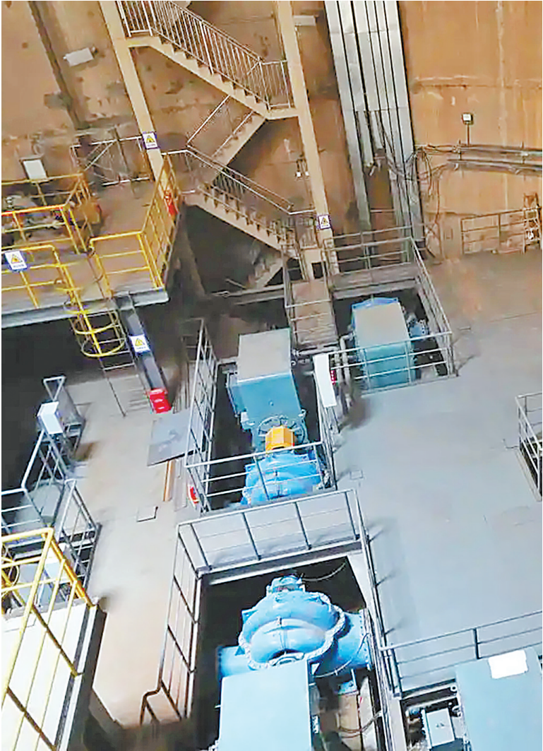
距离长江约300米的取水泵站内部景象。(新华社发)
