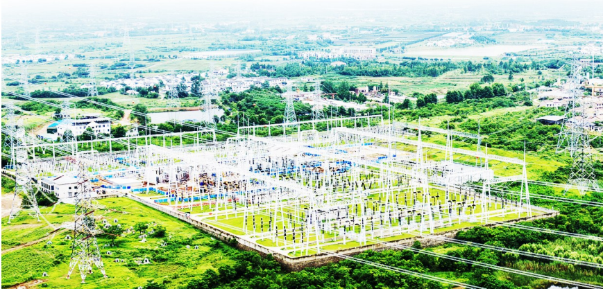
500千伏道观河主变扩建工程近日正式投运。(汤蓓 摄)
