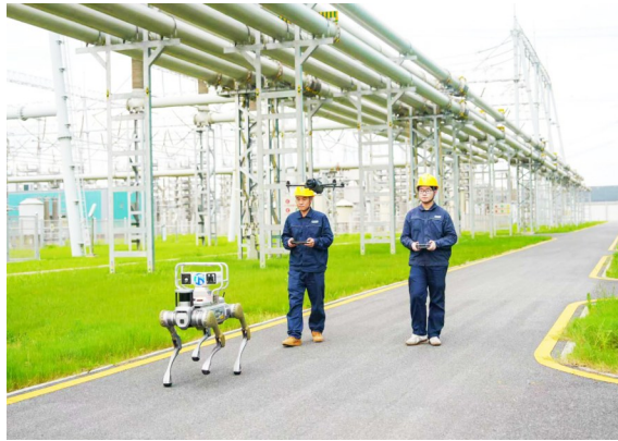
国网湖北电力员工操作机器狗和无人机对特高压武汉换流变电站设备进行巡检。(程锦 摄)
