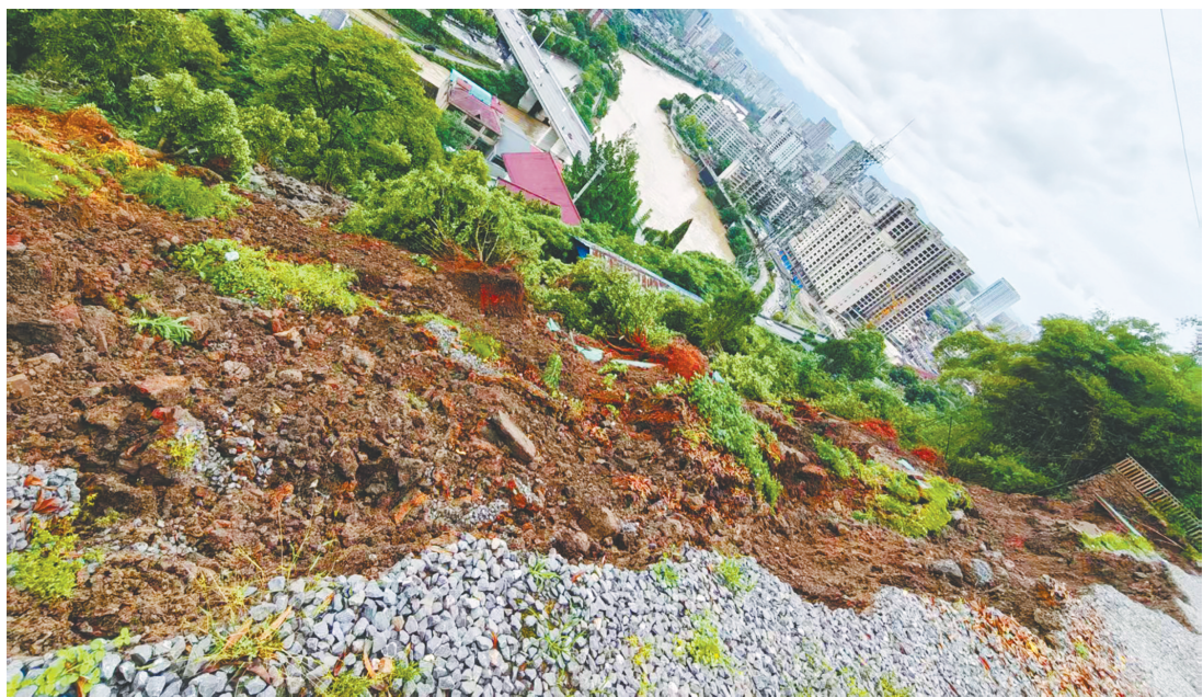
山体滑坡坍塌现场。(舞阳坝街道办事处供图)
