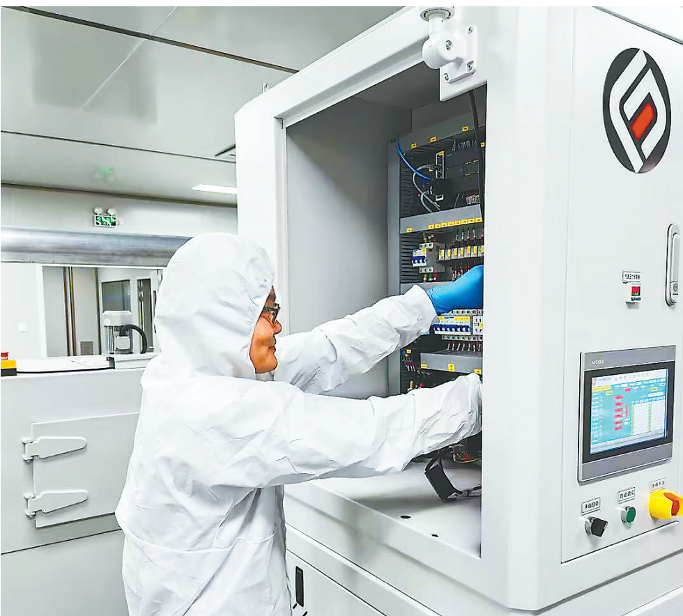
研发人员在洁净车间对燃料电池核心部件生产设备进行调试。(受访单位供图)
