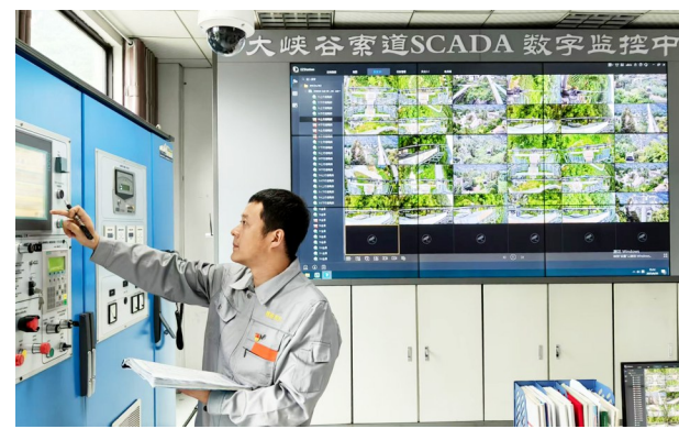
工作人员在总控制室进行日常数据检查和抄录。
