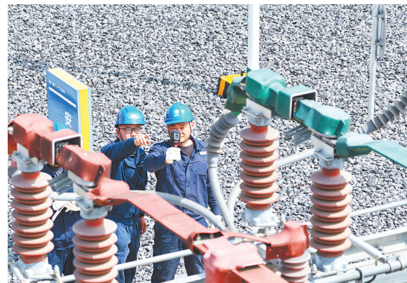
大悟县供电公司人员对中广核大坡顶风电场110千伏升压站进行红外测温,确保风电输送电力设备运行正常。
