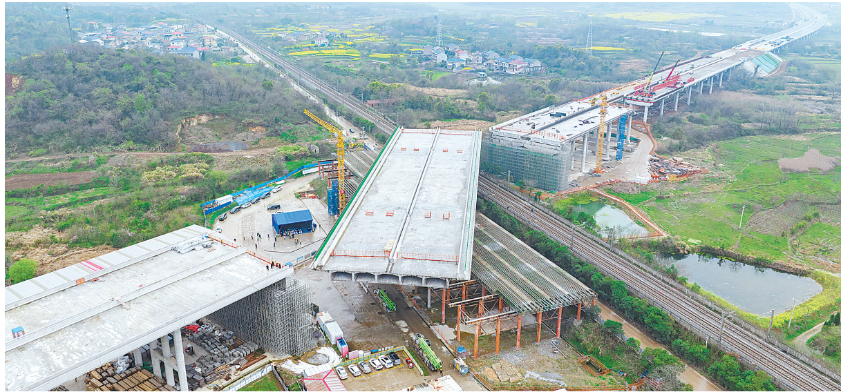
3 月 26 日,重达 2.6 万吨的公路转体桥顺时针旋转 61.1 度,跨越了运输繁忙的国家干线铁路——武九铁路。(视界网 石勇 张成 王可 摄)
