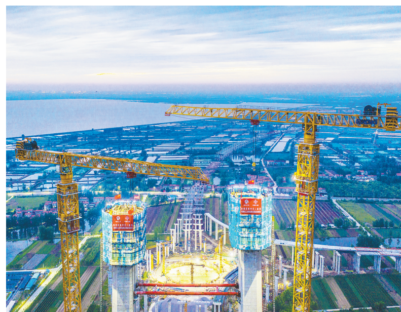
中交二航局、中铁大桥局项目部采用一体化智能筑塔机提升施工效率。
