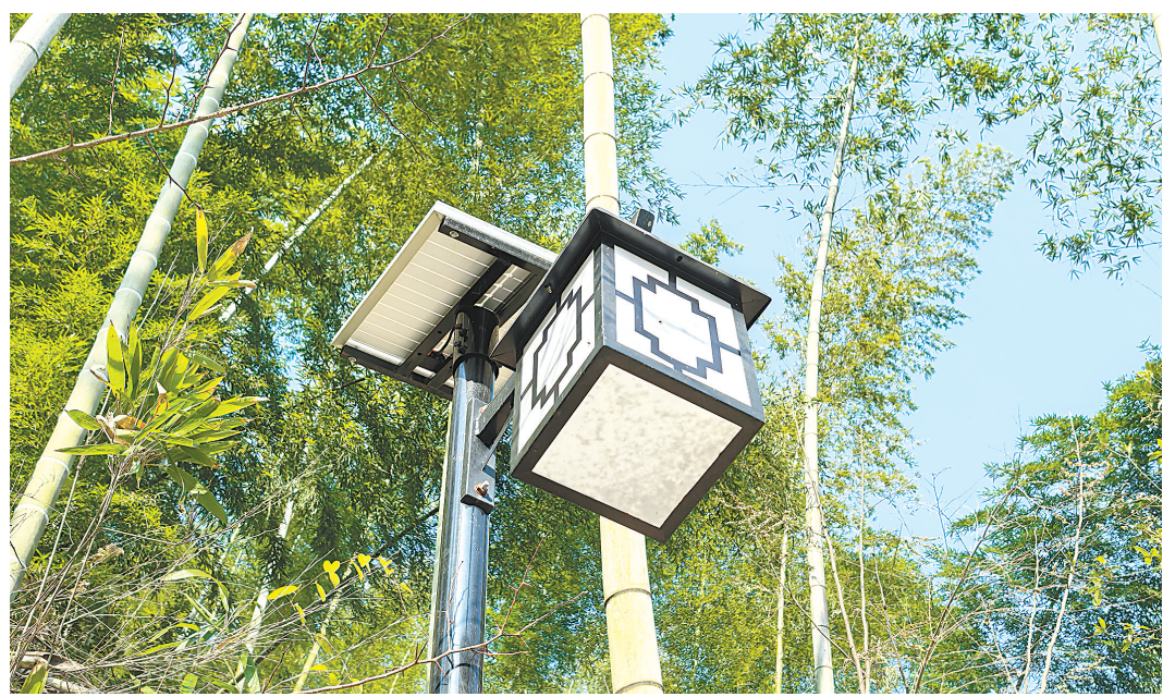
九宫山安装太阳能路灯节能减排。
