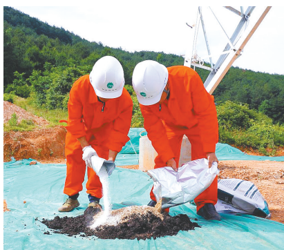
国网湖北电科院现场施工人员正在配置生态种子包,进行塔基区植被恢复。(湖北日报通讯员 占海歌 摄)
