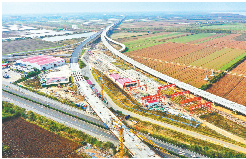
11月26日,武汉至松滋高速公路武汉段工程全线贯通。(湖北日报全媒体记者 倪娜 通讯员 王观生 朱冬娟 摄)
