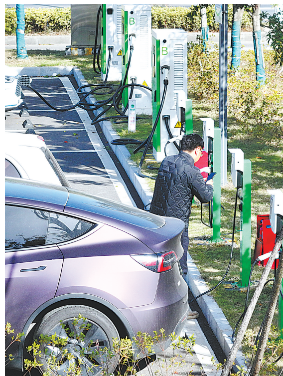
11月28日,市民在襄阳月亮湾公园新能源充电站扫码充电。
