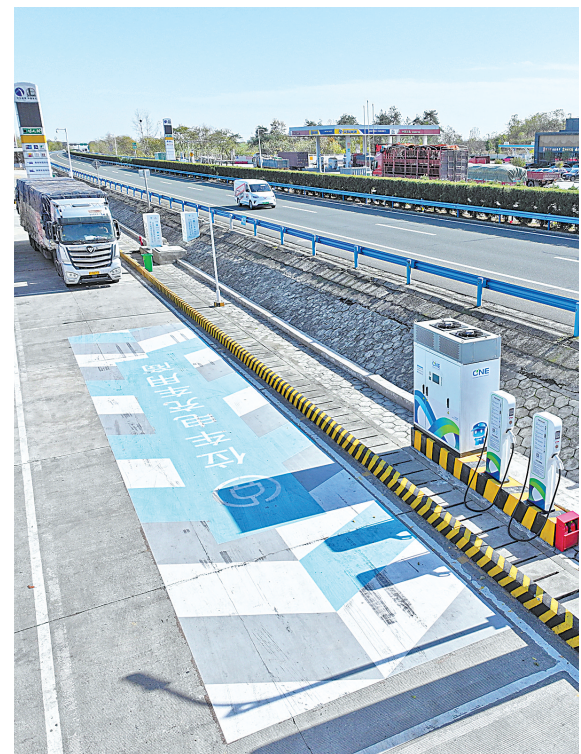
11月27日,襄阳钟岗服务区超级充电桩并排而立,它们专为电动商用车卡补能充电。
