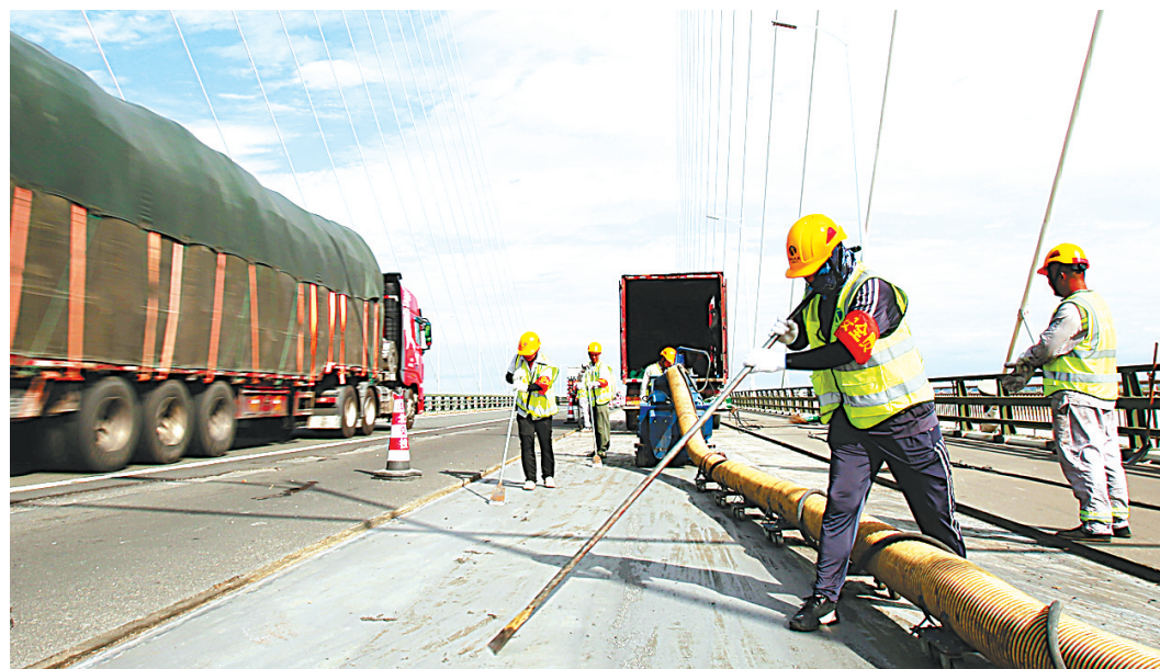
8月1日上午,湖北交投江汉运营公司洪监路段,养护工人正冒着高温在荆岳长江大桥进行沥青摊铺前的检查工作。连日来,荆州持续高温,却是沥青摊铺作业的黄金施工期。江汉公司为了全力打造安全舒适的行车环境,养护人员坚守一线对路面进行洗刨和摊铺作业。(湖北日报通讯员 祝巍 摄)
