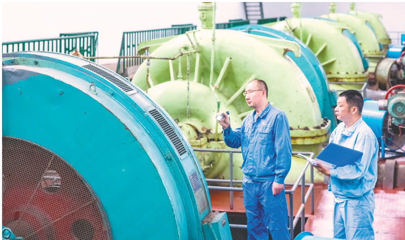
6月27日,黄石胜阳港泵站,工作人员在巡查泵机运行情况。入汛以来,黄石加大各排涝泵站设施设备巡检力度,开展24小时值守,排查险情隐患,筑牢汛期安全防线。(湖北日报全媒体记者 薛峰 通讯员 周雅 摄)
