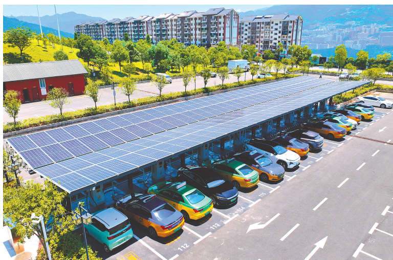
6月12日，在巴东县首个“光储充”一体化充电站，新能源车正在充电。“光储充”一体化系统将光伏发电、储能技术、充电站以及能源管理相结合，实现光伏发电自发自用，有助于节能减排。（视界网 焦国斌 摄）
