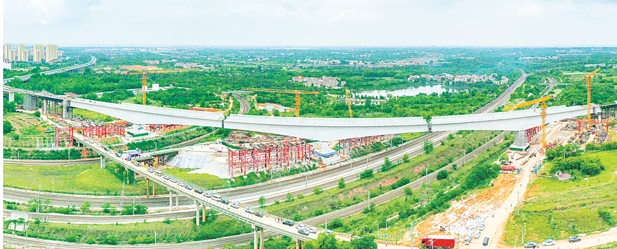
5月22日,在武汉市黄陂区横店武汉轨道交通7号线前川线二期工程涉铁一标段工程现场,最后一个跨铁路主墩连续梁成功转体。(湖北日报全媒记者 倪娜 通讯员 曾斯 袁永华 摄)
