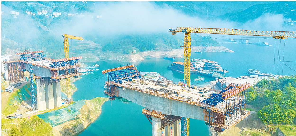
4月12日,工人在秭归茅坪镇三峡枢纽茅坪港疏港铁路建设工地施工。目前疏港铁路工程进度过半,预计2025年底前建成通车。该项目位于宜昌市境内,全长39.59公里。铁路建成通车后,将连接坝上茅坪港、坝下白洋港,形成无缝衔接、装卸一体的“铁水联运”模式,进一步完善长江三峡综合交通运输体系,提升三峡枢纽的翻坝转运速度和运输效率。(视界网 郑家裕 摄)
