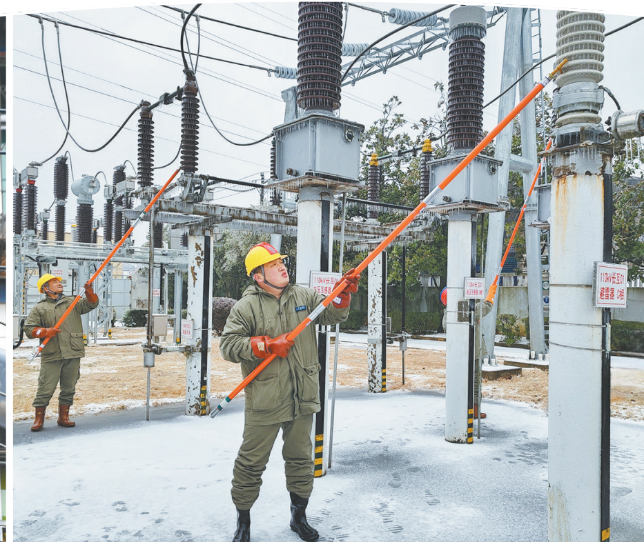
国网武汉供电公司员工维护变电站。
