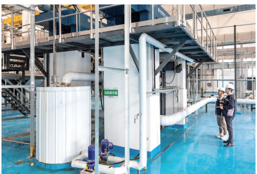
固废处置项目厂房内景。
