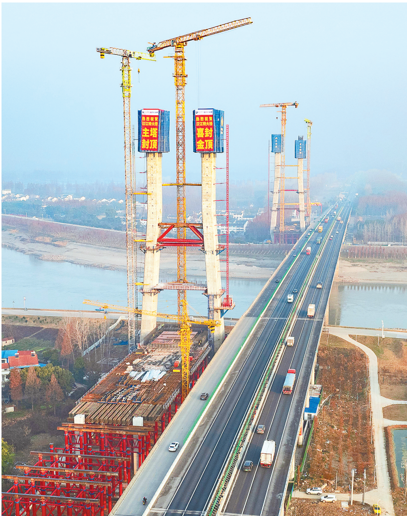
1月12日,京港澳高速新汉江特大桥主塔封顶。(湖北日报全媒记者 柯皓 摄)
