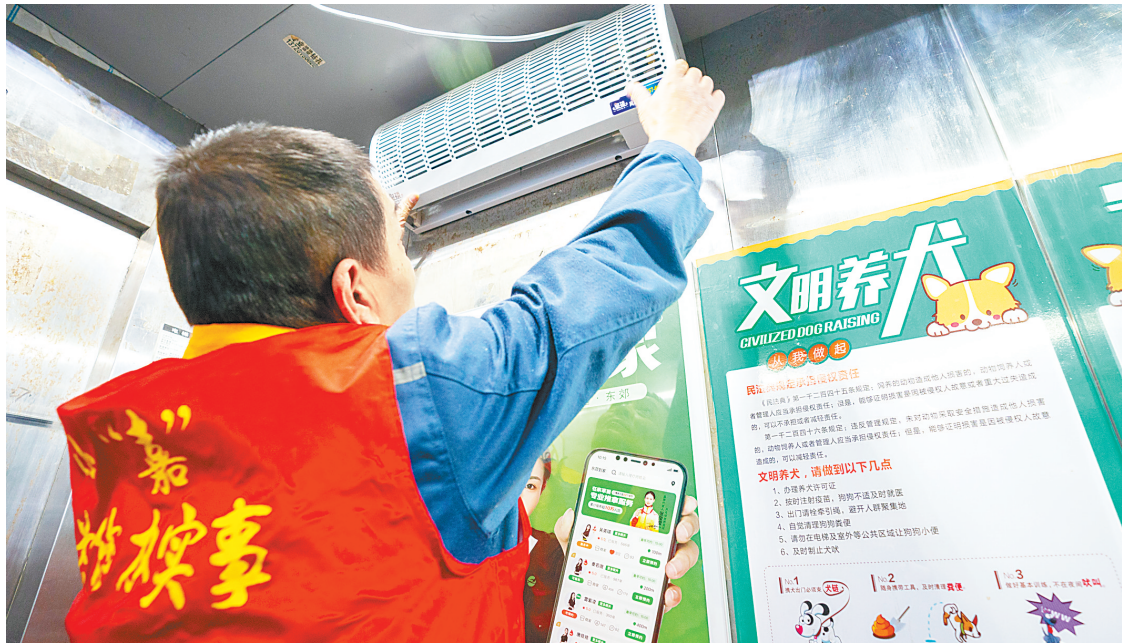
图为列电小区物业工作人员检修电梯里的卧式电表。(湖北日报全媒体记者 魏钰 摄)
