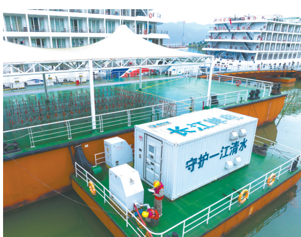
国网湖北电力员工在宜昌市秭归县港巡检长江岸电设施,守护一江清水。
