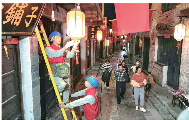
“鄂电红马甲”通过灯笼闪烁情况判断供电线路是否完好。(张家广 摄)
